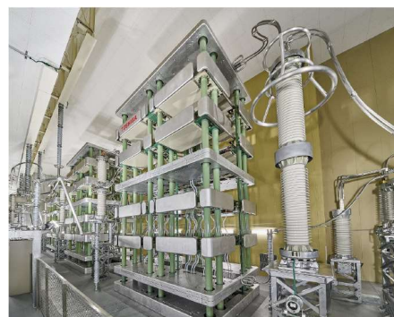
(b) 新信濃変電所側
